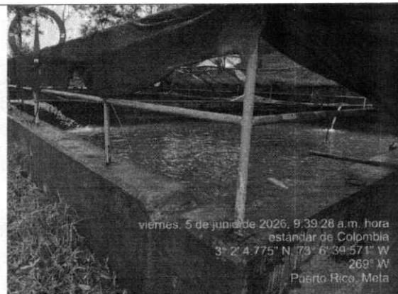
Fotografía 6. Sistema de tratamiento de aguas subterránea
