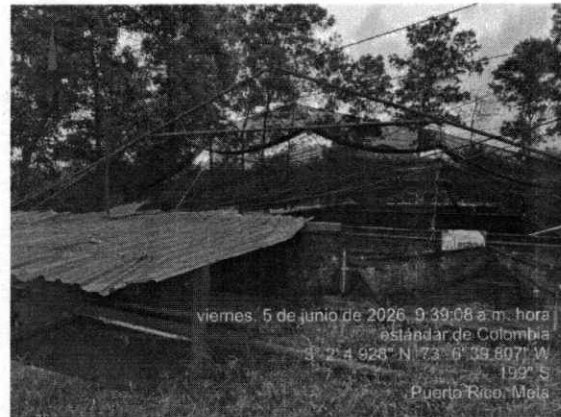
Fotografía 4. Sistema de tratamiento de aguas subterránea
